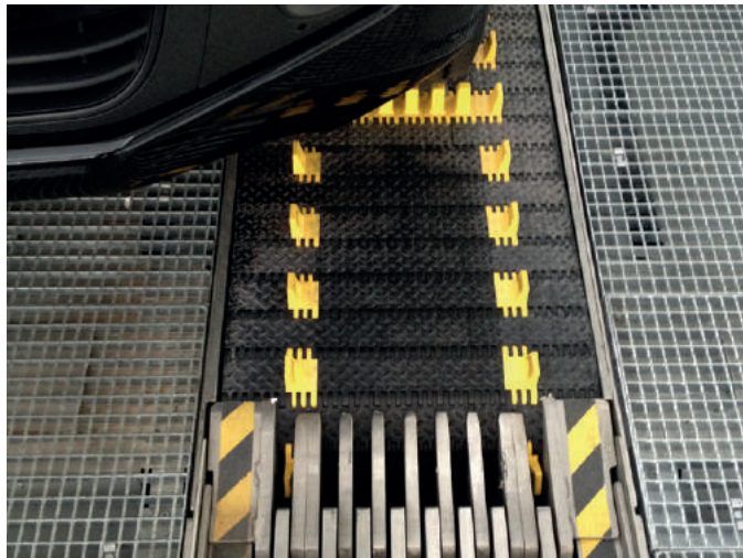
3125 MatTop in Außenwaschanlage
